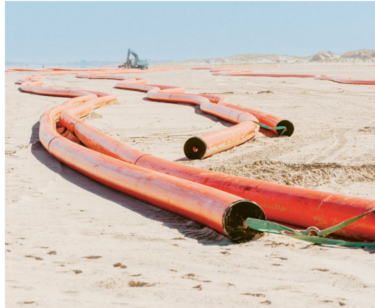
Kabelschutzrohre am Strand von Norderney
