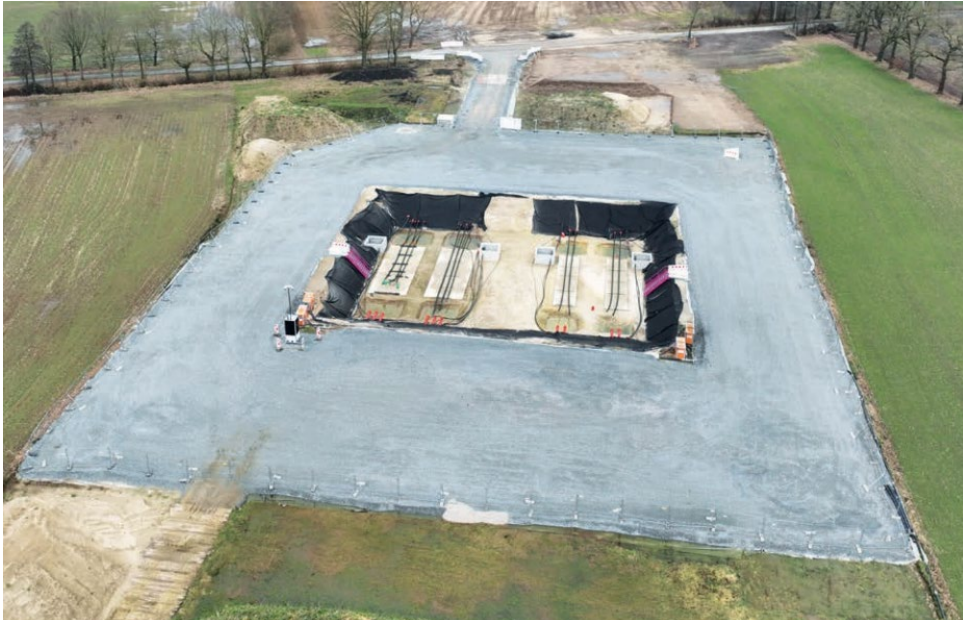
Bildquelle: Amprion GmbH / IPA A-Nord
