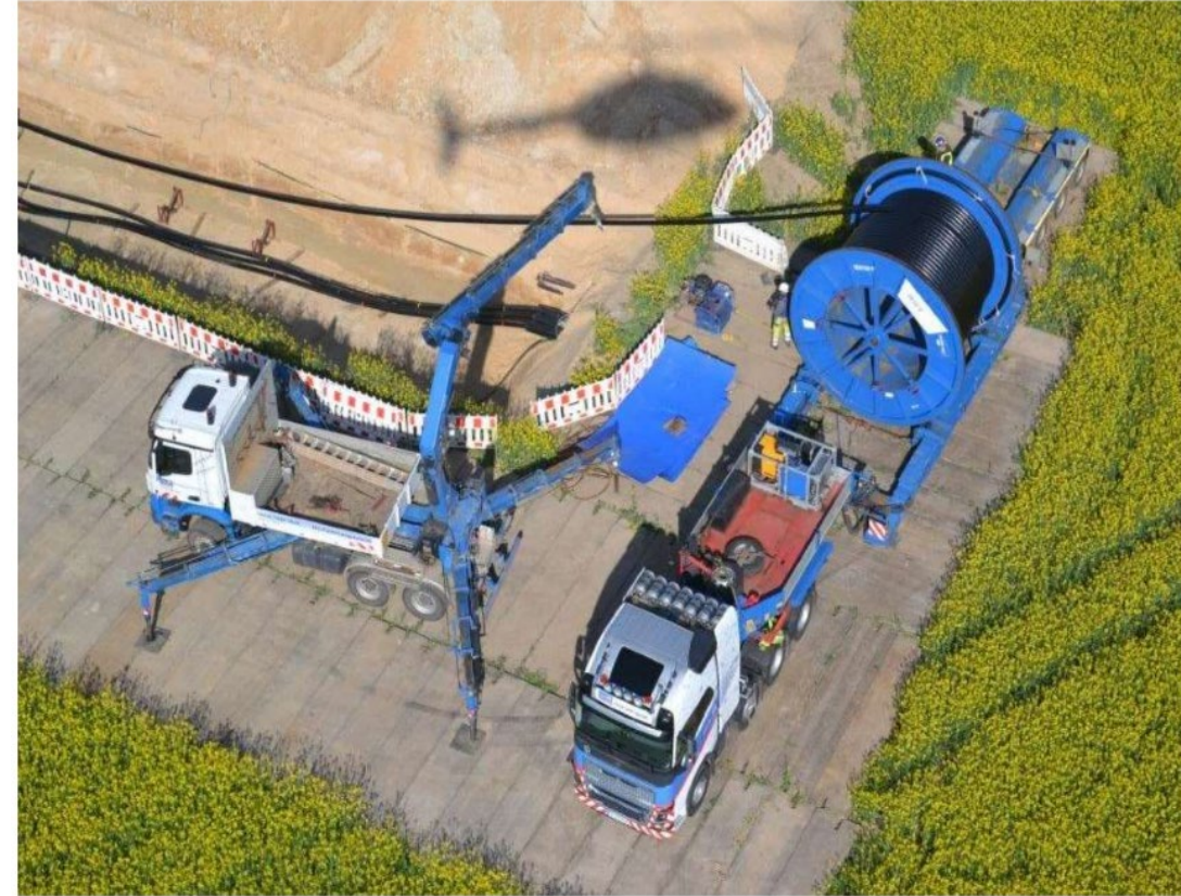
Bildquelle: Prysmian Projects Germany GmbH
