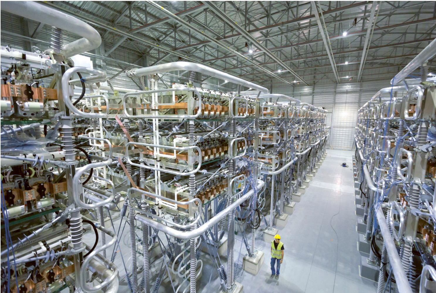
Blick in die Konverterhalle der Konverterstation des Projekts ALEGrO in Oberzier
