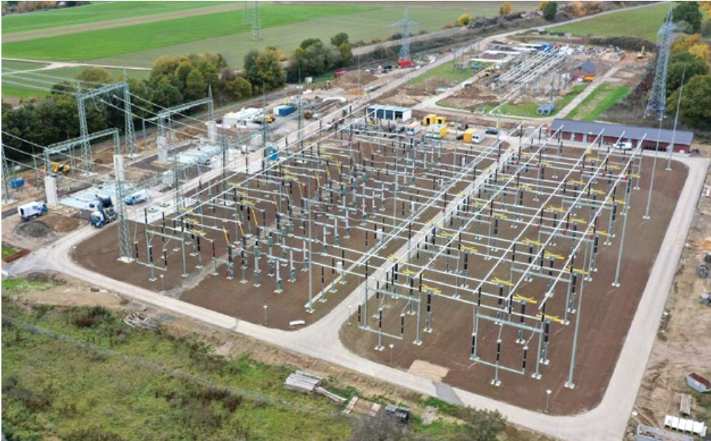
Drohnenaufnahme einer Schaltanlage
