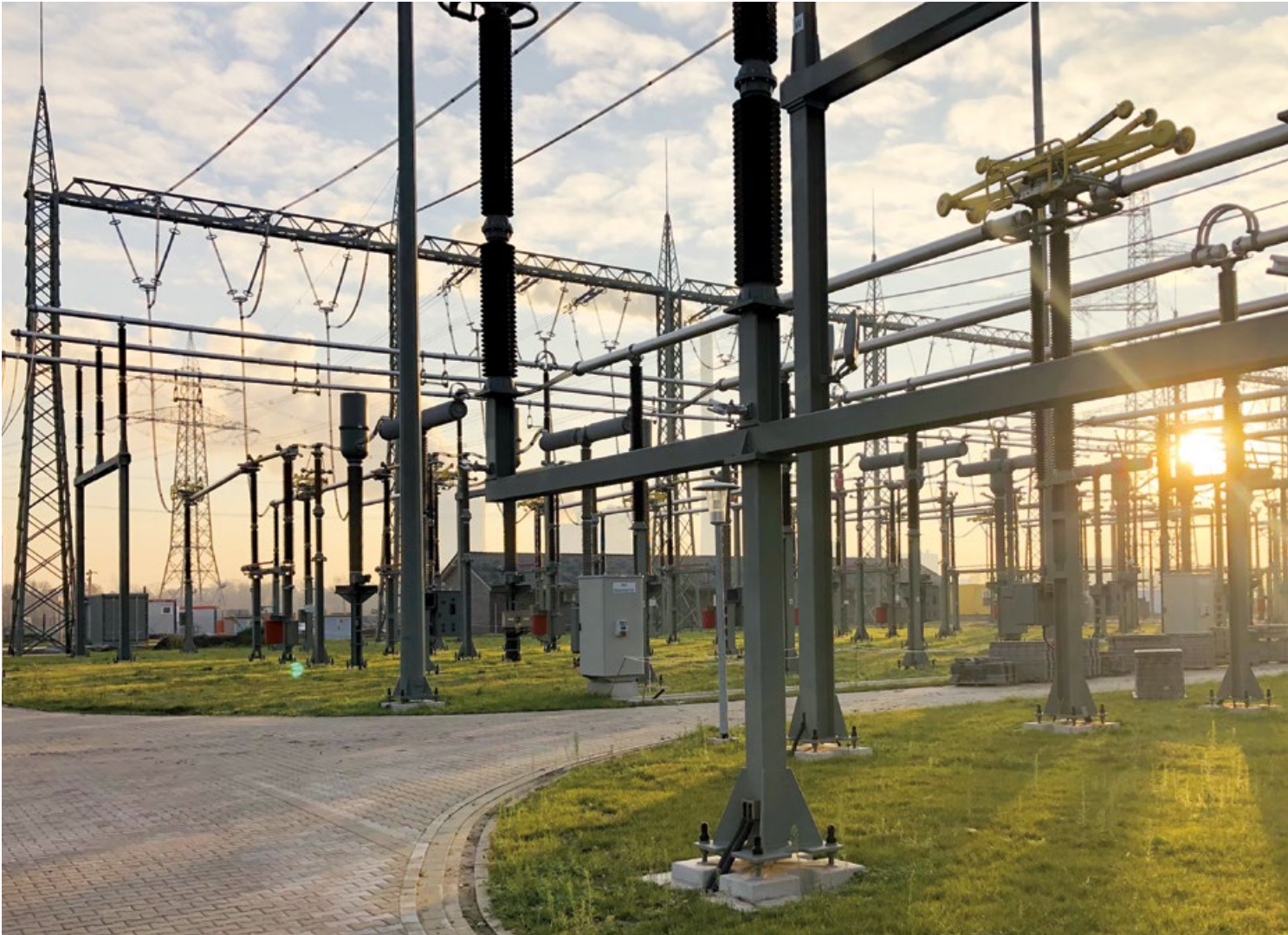
Leitungsfeld einer Freiluftschaltanlage
