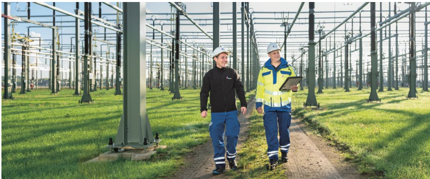
Für die Einrichtung von Schalt- und Umspannanlagen werden bereits sehr früh geeignete Standorte geprüft
