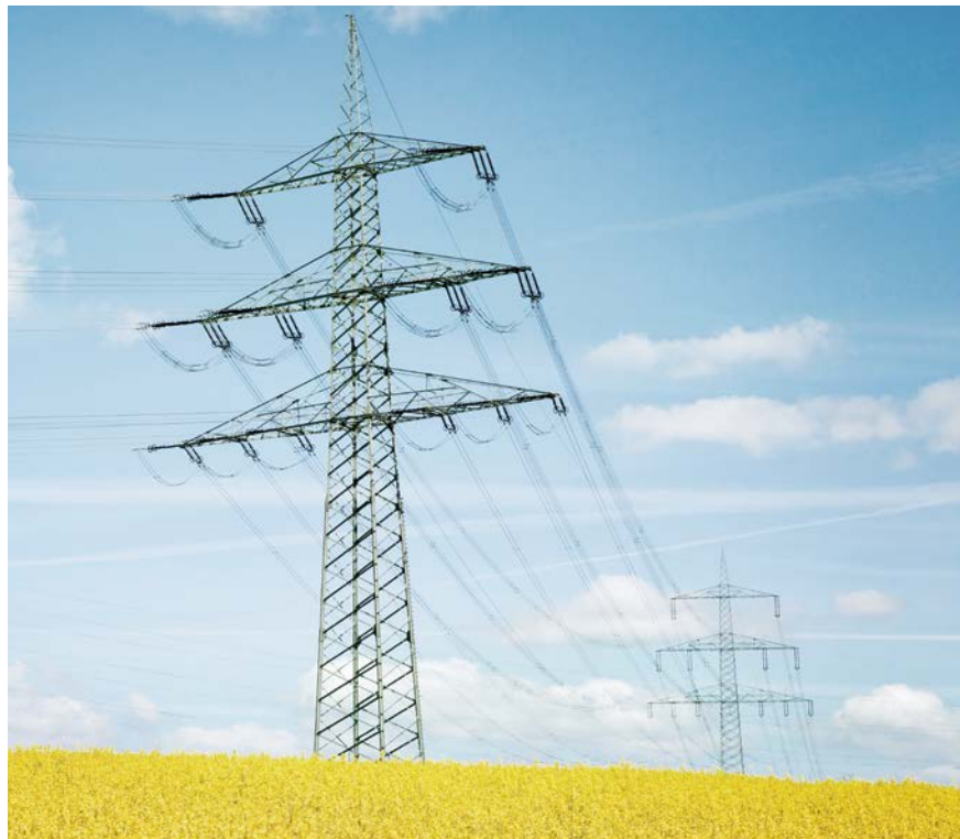
Abspannmaste: Die Isolatorenketten verlaufen beinahe parallel zum Boden.
