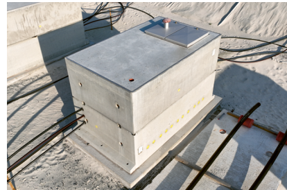
Abbildung 6 Zugangsschacht an einer Erdungsmuffe
