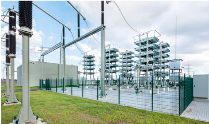
Die leistungsstärkste Hybrid-Umspannanlage im europäischen Stromnetz steht in Kriftel. Mit dieser stabilisiert und sichert Amprion die Stromversorgung des Rhein-Main-Gebiets.
